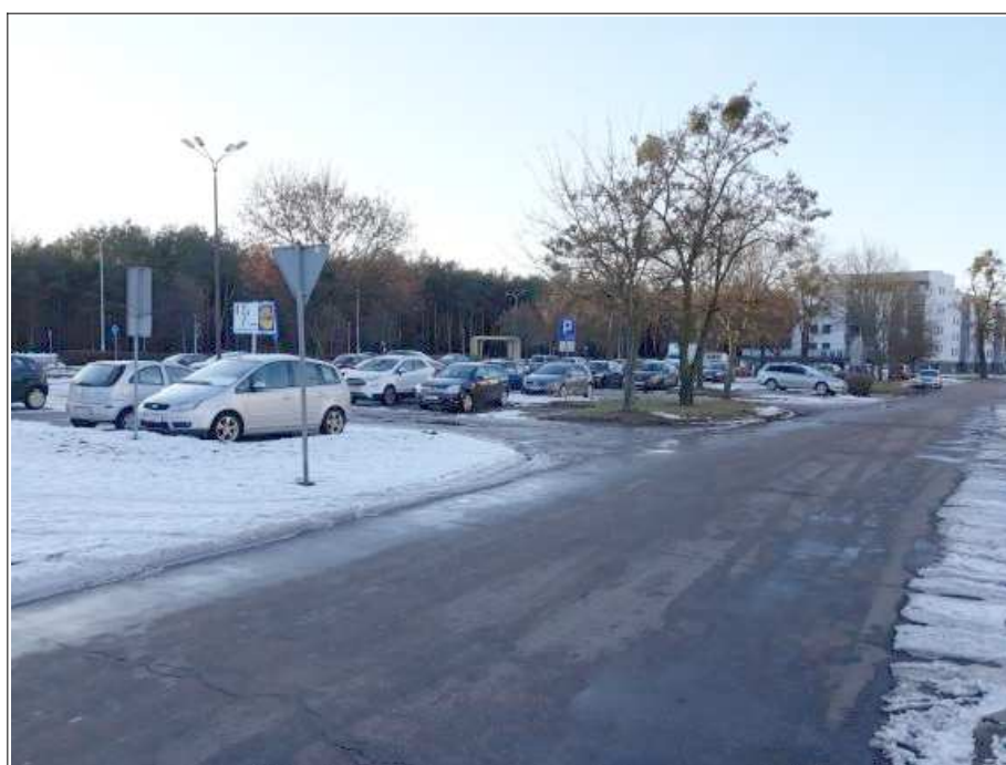
Popękana betonowa nawierzchnia drogi dojazdowej w granicach wyznaczonego terenu KDW , w tle tereny parkingów planowanych pod zabudowę mieszkaniową wielorodzinną ( MW ).
