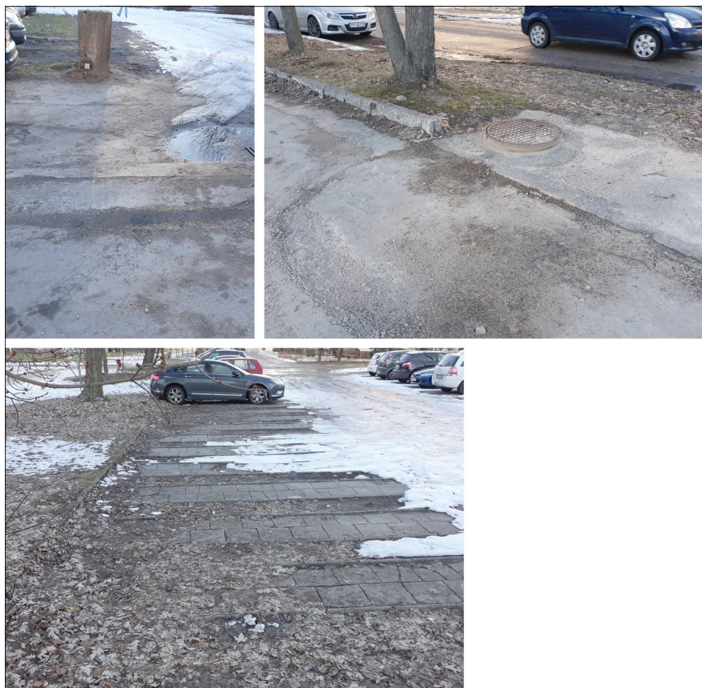
Zniszczone nawierzchnie parkingów w granicach wyznaczonego terenu MW .
