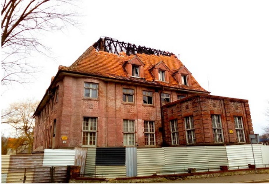
Budynek Miejskiej Kasy Chorych. Widoczne uszkodzenia dachu po przebytych pożarach
